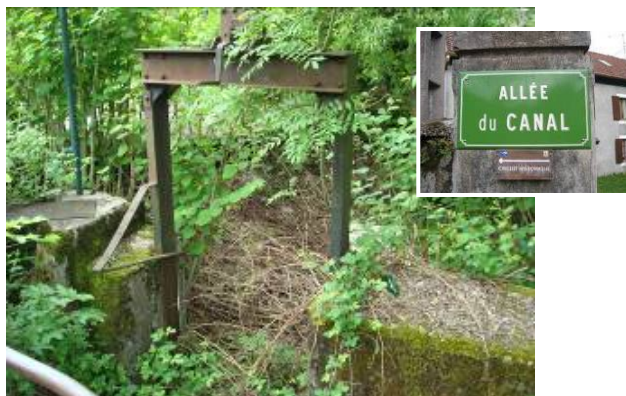
Vanne de fermeture, située allée du Canal et témoignant de la présence d'anciens canaux parallèles à la Savoureuse. Ce « petit patrimoine » aujourd'hui totalement oublié, se doit d'être à nouveau révélé.
